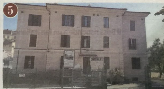
5 Chi ha resistito La caserma dei carabinieri, da una prima ispezione esterna, sembra abbia retto, grazie alla forma simmetrica e alla presenza di catene in cima (i quadretti scuri) da poco inserite. È stata comunque evacuata
