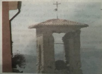
6 Quei calcoli errati Sembra che le catene alla base del campanile della chiesa di Sant'Agostino abbiano impedito il crollo, ma quelle in cima, vicino alla campana, non avrebbero tenuto conto del «piano debole» generato dalle finestre: il tetto è tagliato in due. Il timpano è crollato forse per scarso collegamento con la navata centrale
