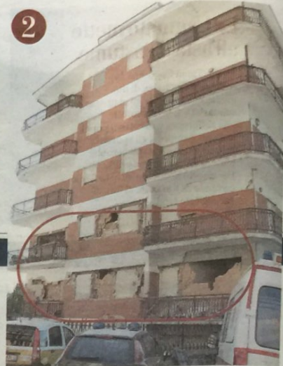
2 Errori di progettazione: il piede d'argilla Edificio di Amatrice in cemento armato che evidenzia il comportamento di «piano debole», con concentrazioni di danni localizzati solo sul primo piano. Accade per un errore di progettazione: la rigidità non è distribuita uniformemente in altezza
